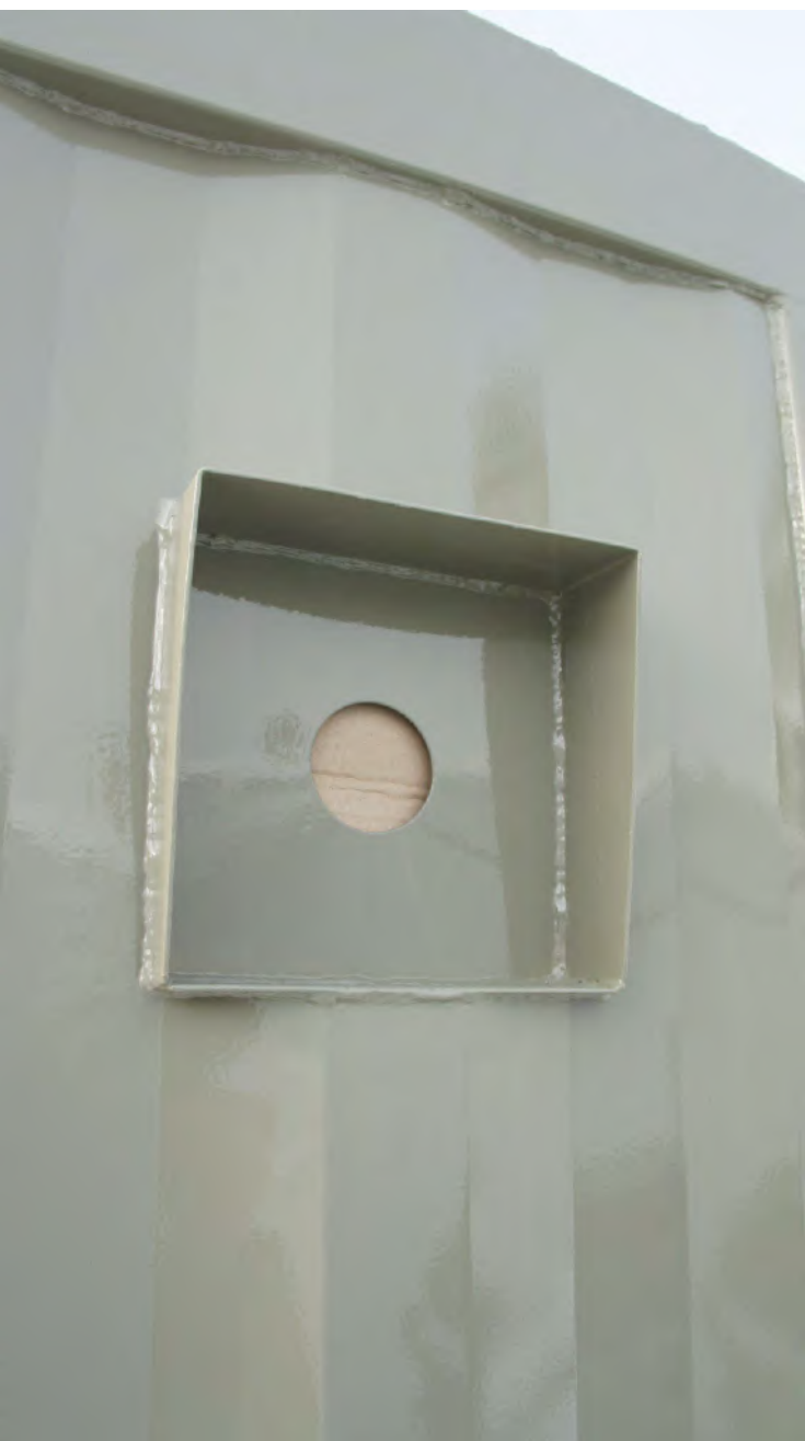
Узел вывода дыхательного трубопровода
